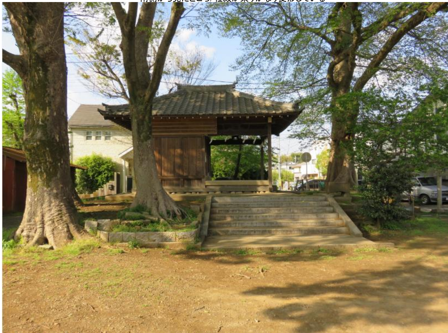
南側から見たところ/社殿が乗りかなり変形している
