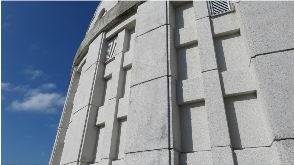
これが中央大塔の下部壁面
