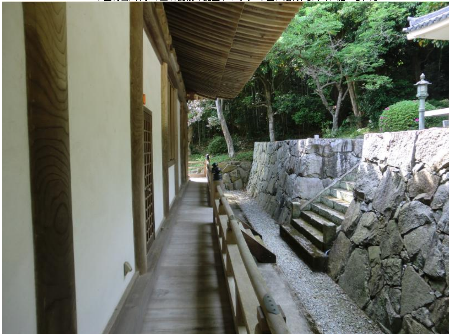
本堂背面/右手の玉石乱積の擁壁(コンクリート壁に貼付)も同時に施工された
