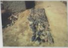
櫓門雨落ち施設
